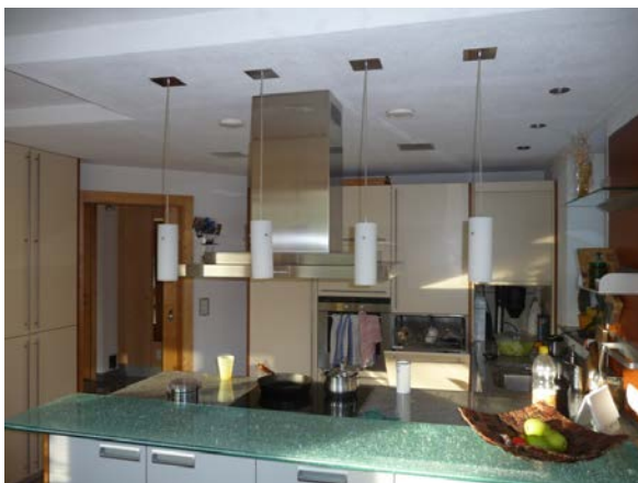
Abbildung 2: Umlufthaube und die beiden (weißen) Ventile rechts und links der Kochstelle bzw. Umlufthaube.
